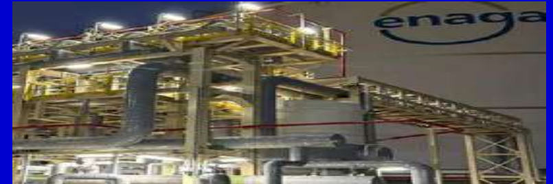
Generación térmica, Barcelona, España
